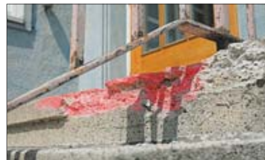
Baufällig und gefährlich? Mit roter Farbe ist eine Treppenstufe markiert, die bereits abgebröckelt ist und als Stolperfalle gilt.
